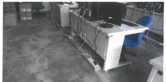
機械科電腦繪圖教室裸露之電腦排線
