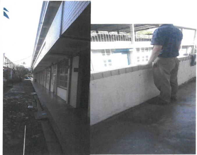
機械科二樓外牆面未設置護欄
