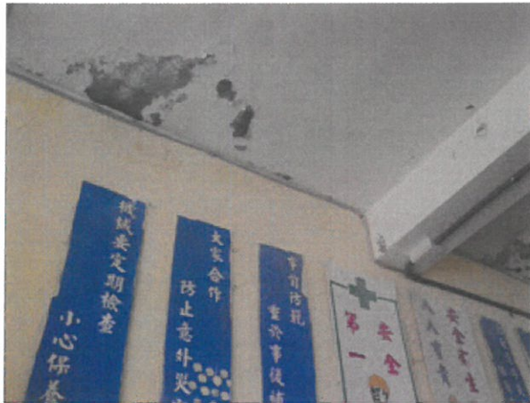
機械科電腦與繪圖教室牆面壁癌剝落情形
