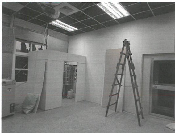
圖 1 植物工廠管線外露部分，整理後外加隔間包覆，讓空間更為簡潔，動線明確。
